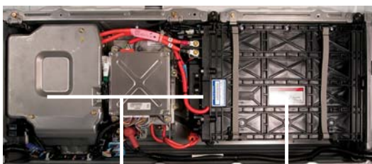
Autres composants sous haute tension
