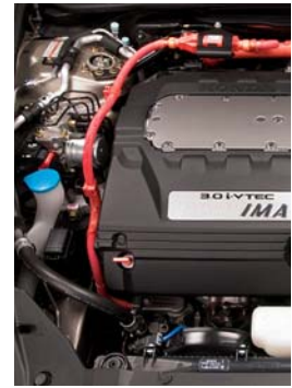
Câble haute tension du compresseur du climatiseur de l'Accord
